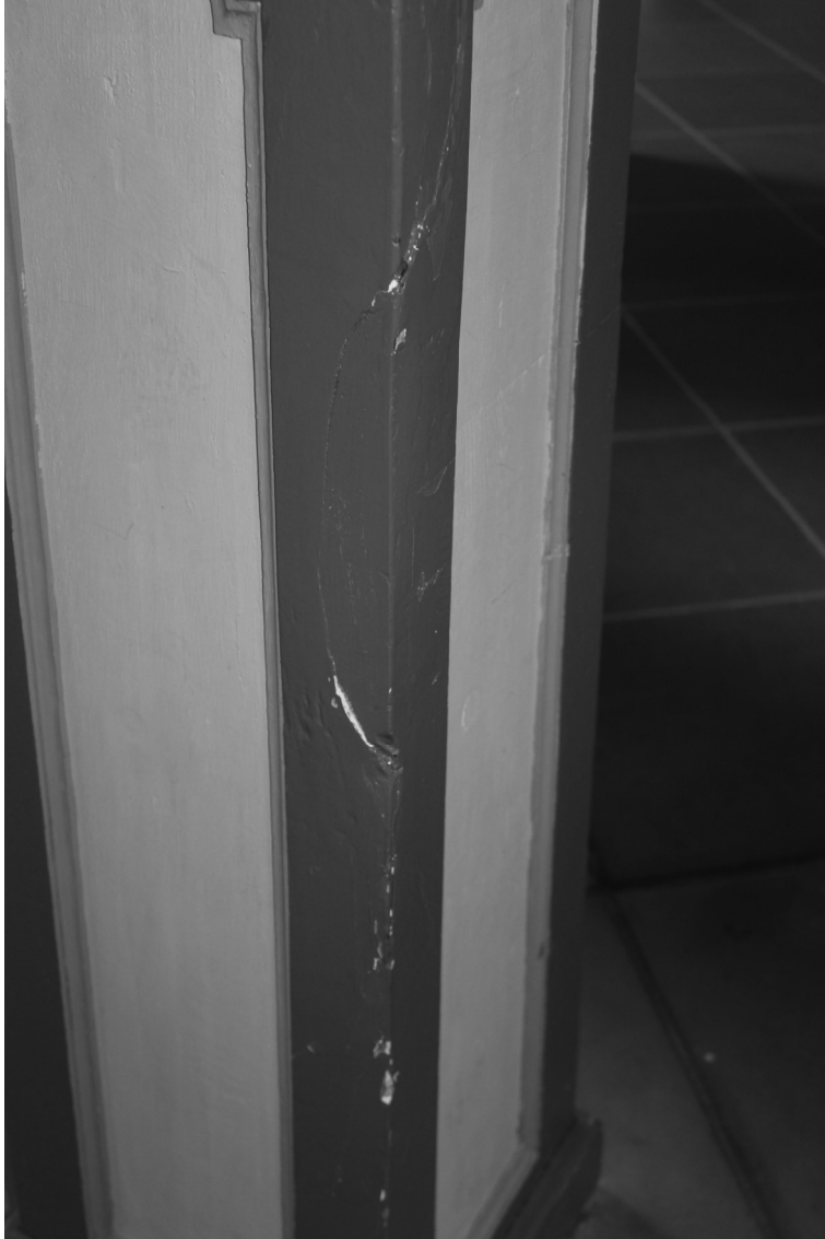
Abb.12: Kantenbereich einer Säule im Sockelbereich mit gekitteten und abgeplatzten Fassungsschichten.
