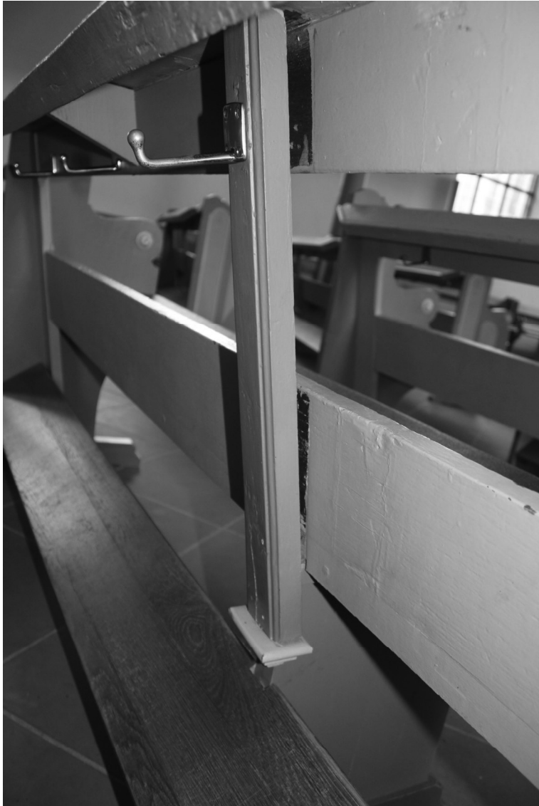
Abb.6: Gelockerte Holzverbindung am Mittelsteg.
