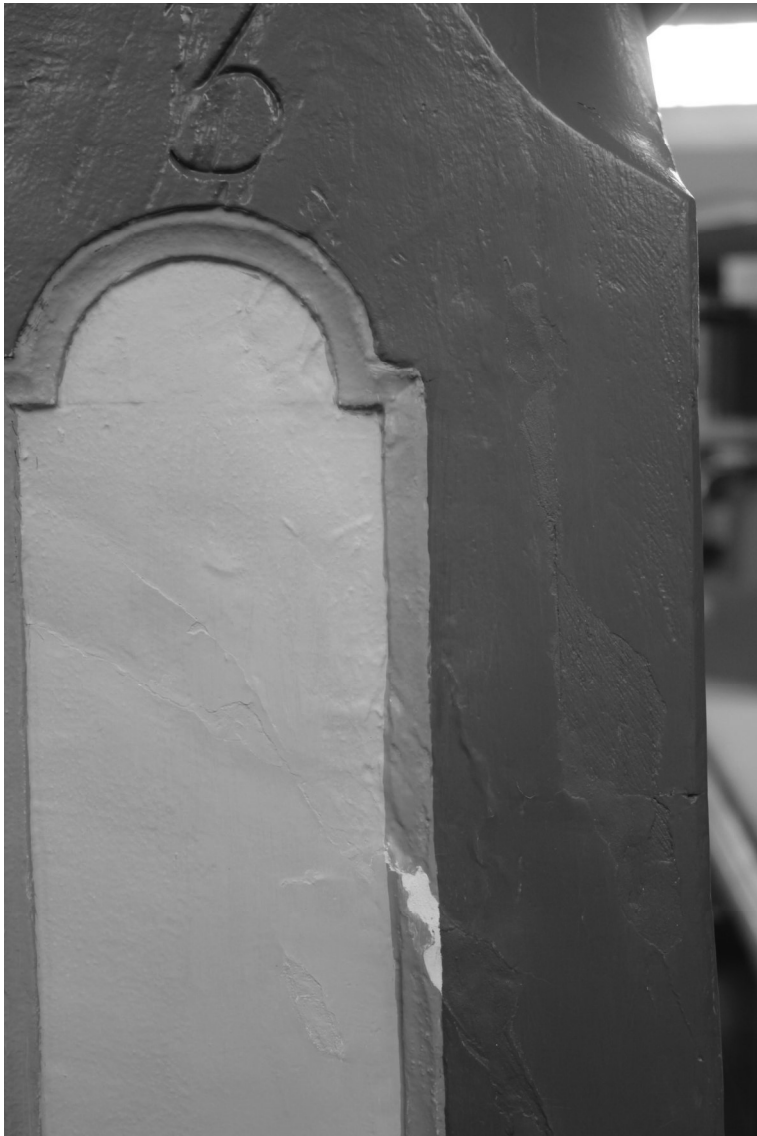
Abb.17: Wangenelement mit gekitteter Oberfläche während der Retuscharbeiten. Im rechten Bereich ist die dunkelgraue Fassung bereits geschlossen.
