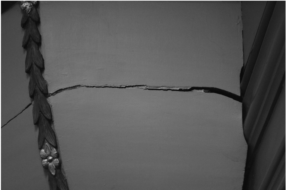
Abb.13: Zierunterbau des Kanzelkorbes, rechte Seite, Trockenriss mit alten Kittresten.
