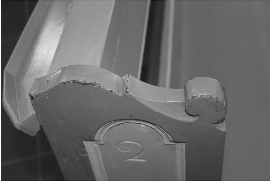
Abb.9: Aufrechtes Wangenelement mit besonders oberseitig bestoßenen Fassungsschichten.
